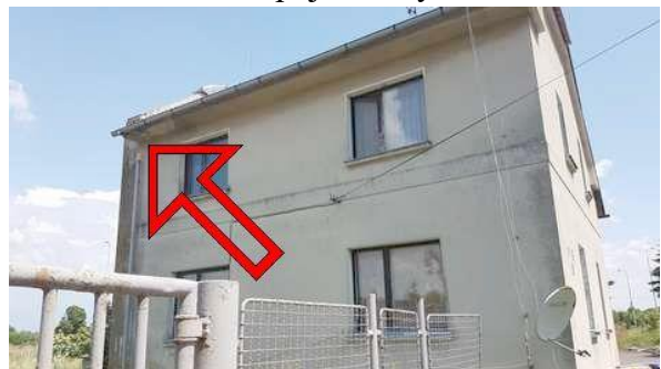
Pohled - poškozené klemp. prvky
