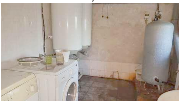
Suterén - vodárna + boilery
